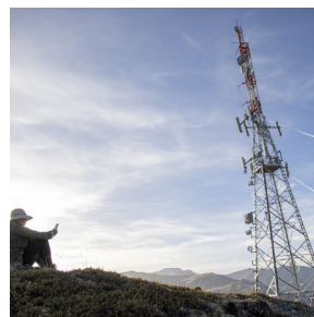
无线通信设备
