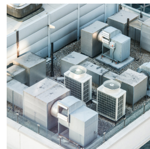
空气处理装置
