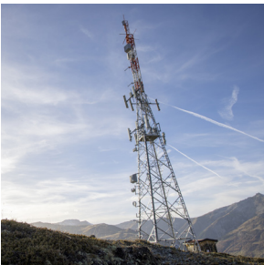
塔式通信系统
