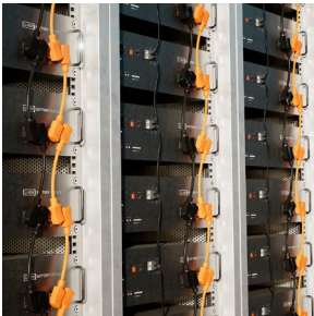
数据中心/电池备用基础设施
