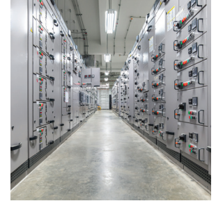
电气开关面板
