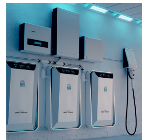
バッテリー貯蔵システム
