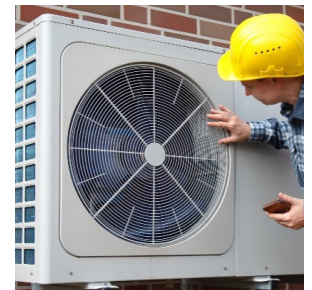
ヒートポンプ
