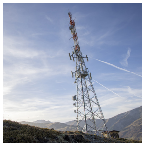
タワーベースの通信システム
