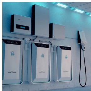
エネルギー貯蔵システム
