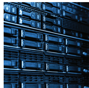
データセンター用サーバー
