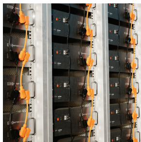
エネルギー貯蔵システム
